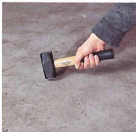
Șapă compactă, omogenă și adecvată pentru montarea parchetului — sunet plin la lovire.
