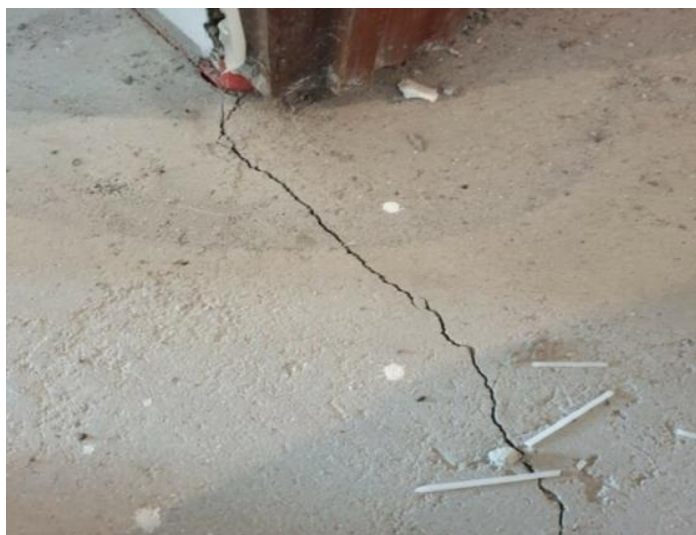
Fisură instabilă — face șapa nepotrivită pentru montarea ulterioară a parchetului.
