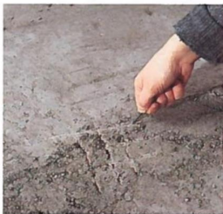
Exemplu de șapă fărâmițată — necorespunzătoare pentru montarea parchetului.
